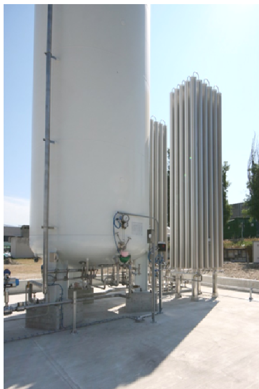
Fig. 3 Esempio di gruppo di vaporizzazione
