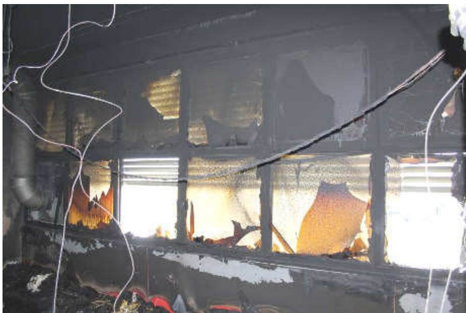
Foto NIA – Vetri di finestre rotti a causa di una sollecitazione termica
