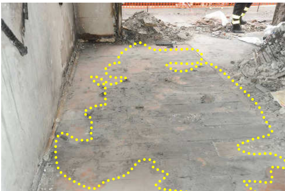
Foto NIA – Segni lasciati a pavimento da liquidi infiammabili
