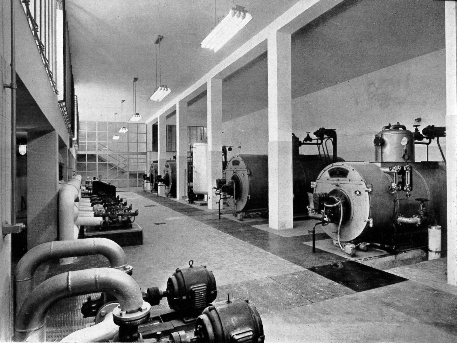
La centrale termica
