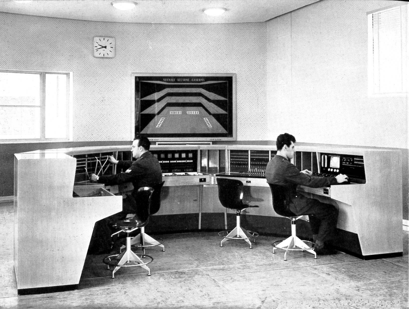
La centrale telefonica e d'allarme
