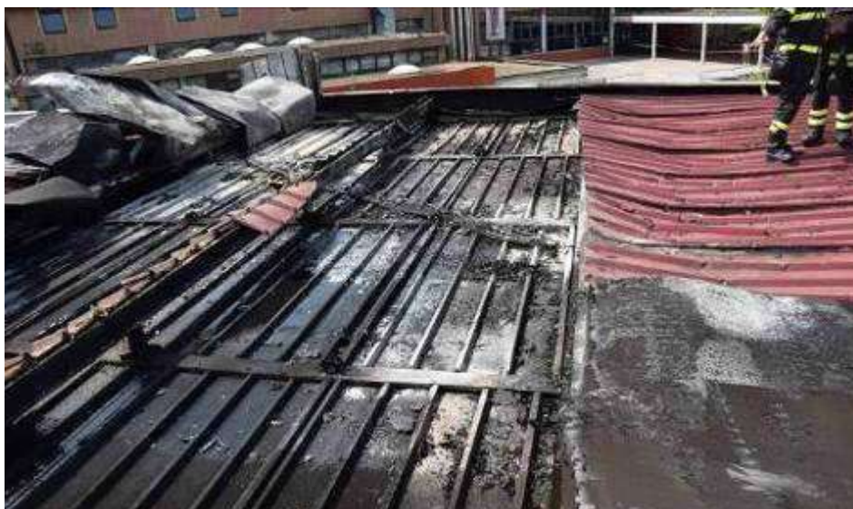
Danneggiamento di parte della copertura
