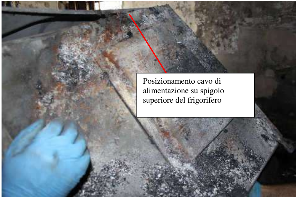
Cavo elettrico di alimentazione del frigorifero
