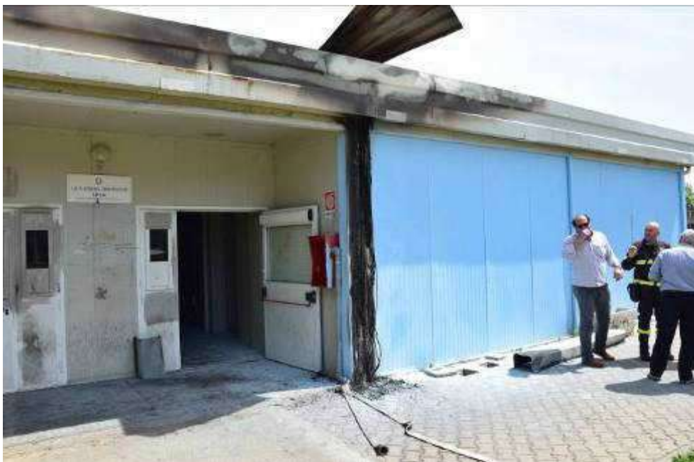
Tratto verticale del passaggio dei cavi elettrici
