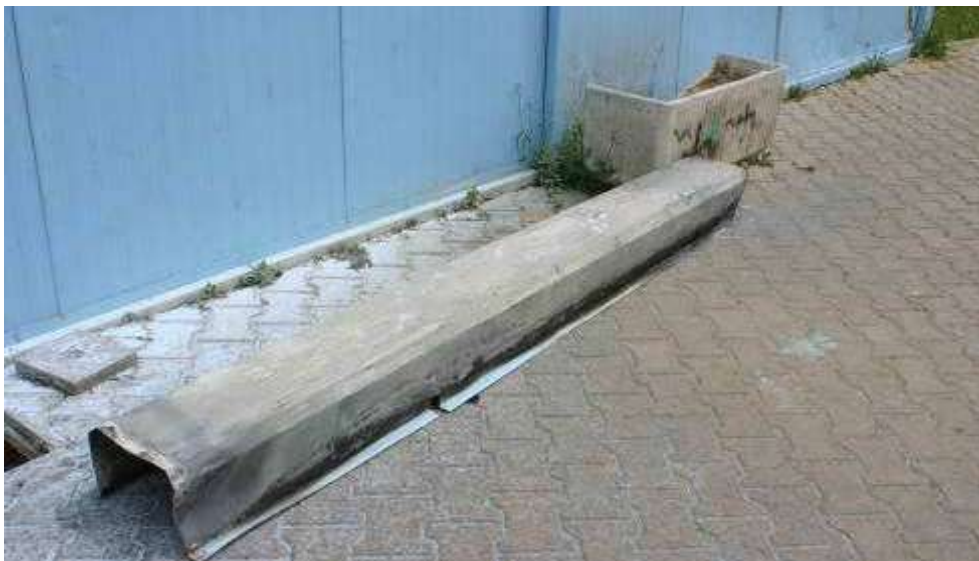
Lamiera metallica posta verticalmente a protezione dei cavi elettrici
